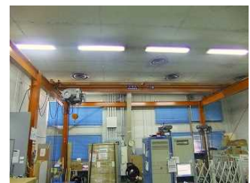
試験室内の走行クレーン
